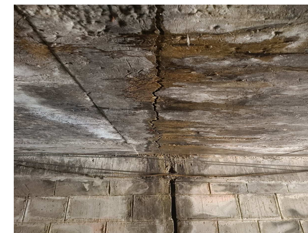
7#涵洞涵身沉降缝开裂
