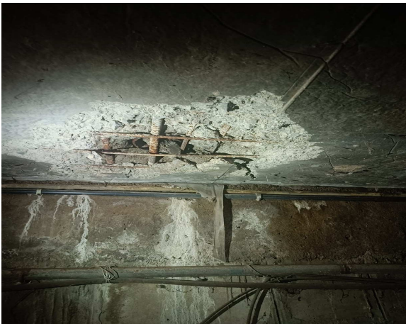
9#涵洞盖板坑洞
