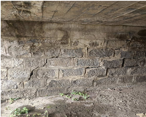
3#涵洞涵台裂缝
